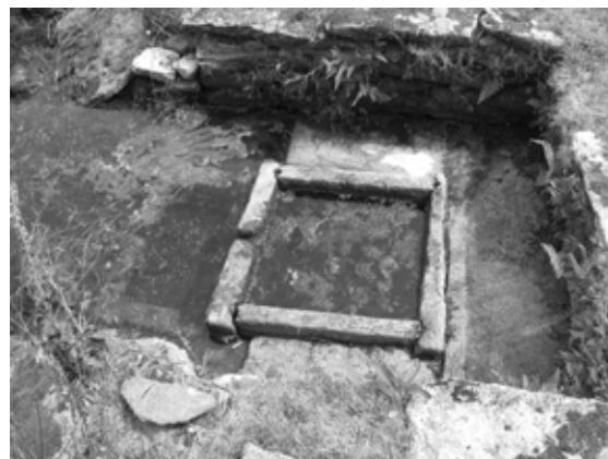
Fig.: 5. Estado actual de la fuente. La rotura del aislamiento provoca que se inunde el área de la arqueta pequeña.
